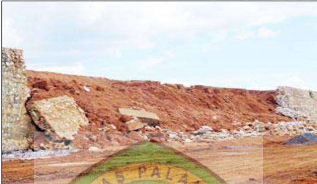
Gambar 4.2 Kondisi Lereng Runway Setelah Terjadi Longsor
