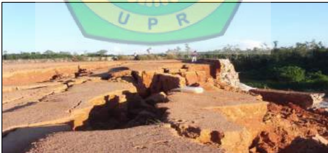
Gambar 4.1 Kondisi Lereng Runway Setelah Terjadi Longsor
